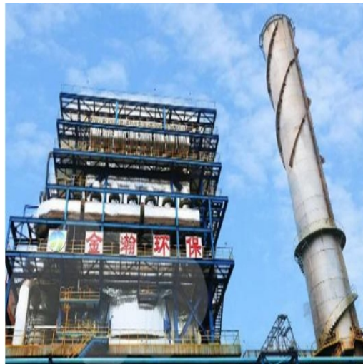
2X180m 2 烧结脱硫脱硝
