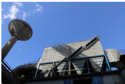
一铁厂 1#高炉炉前除尘
